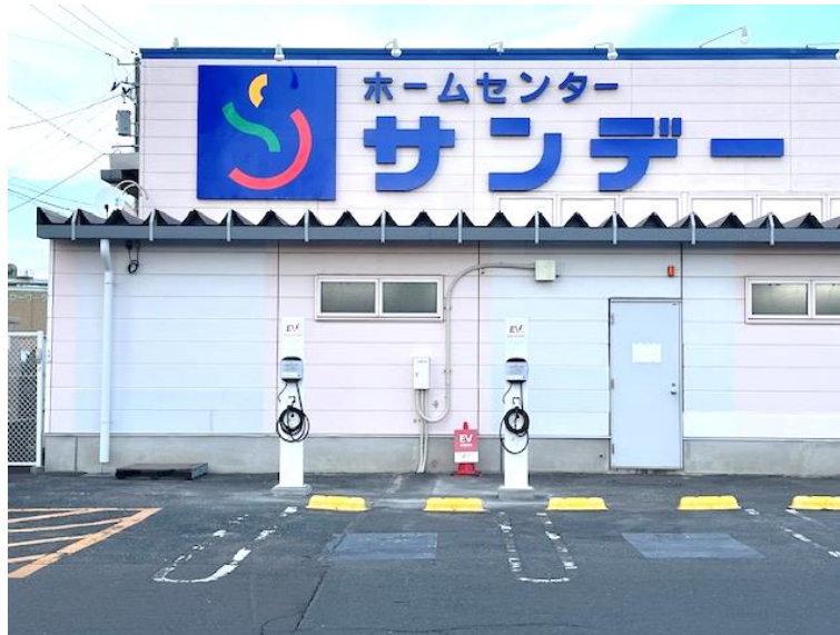
八戸沼館店設置の電気自動車（EV）用充電器
